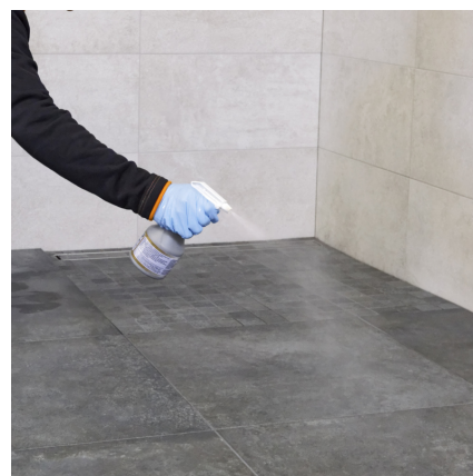
Före den avslutande tvättcykeln ska PCI Durapox Finish (flytande) sprayas på ytan efter ca 60 min.
